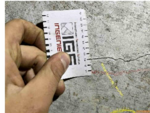
2025S2_BODENPLATTE FELD 2 GERISSEN
