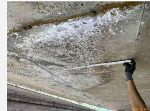
2025S1_BODENPLATTE KOPPELFUGEBEREICH AUSSINTERUNG
